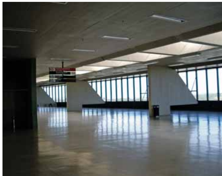
Terraço do aeroporto de Confins: reforma permitiu a criação de um espaço com iluminação uniforme, livre de contrastes excessivos.
